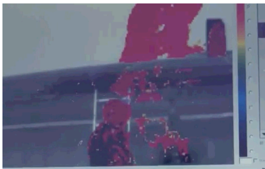
Figure 1 : Emanations de gaz méthane détectées par rayonnement infrarouge sur une cuve de méthaniseur.
